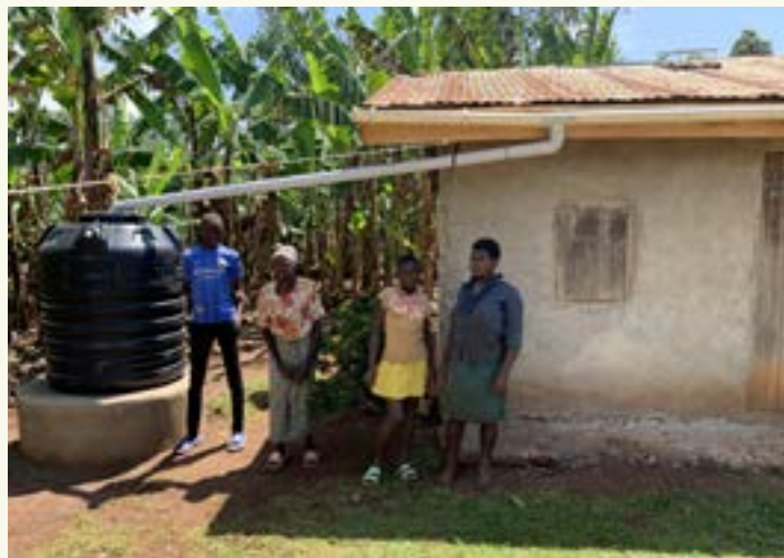
Dank Regenwassertank gibt es jetzt Wasser am Haus
